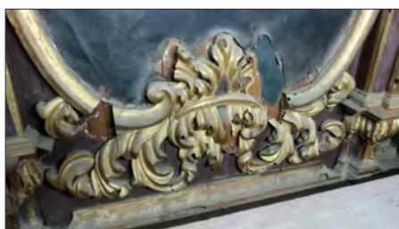
Estado de conservación del soporte lúneo, ataque de termita (arriba) y pérdidas de materia en el ático (abajo)
